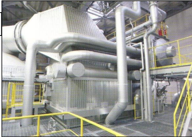
دیگ بخار (Boiler)
